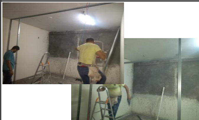
Figuras 01 e 02: Instalação da estrutura metálica da parede de acartonado na sala do TI;
