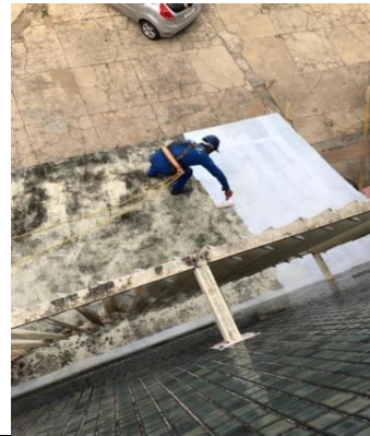
Figura 02: Foi feito a aplicação de manta líquida impermeabilizante na parte de cima da marquise;
