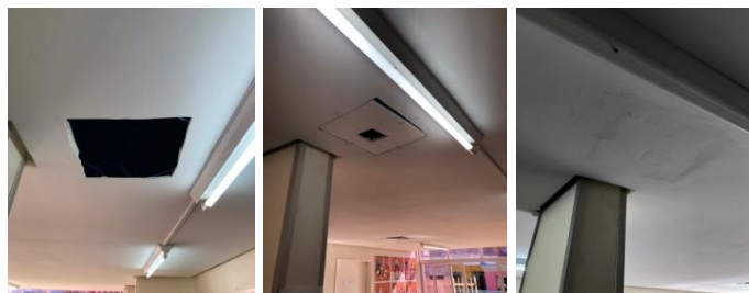
Figuras 08, 09 e 10: Foi feito o fechamento de uma abertura no gesso com a utilização de gesso placa;
